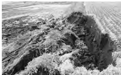
荒瀬原地区 田の法面崩落
