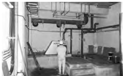
古海浄化センター 流入室天井の高さまで水没
