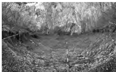
斑尾林道 林道崩落
