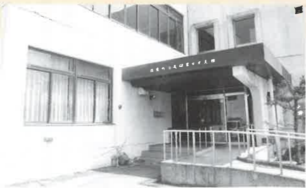
修繕が必要な富士里支館
