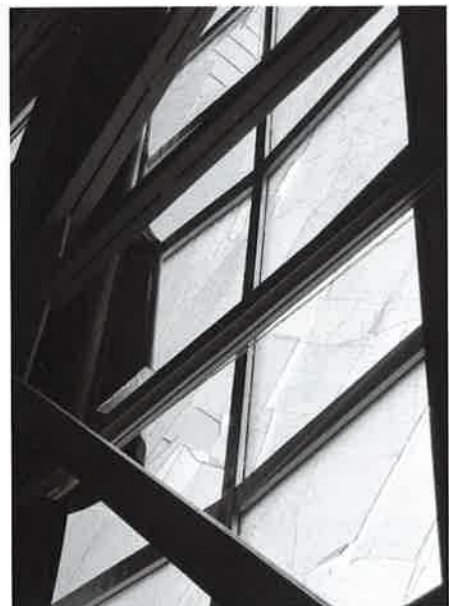
総合体育館の被害状況
