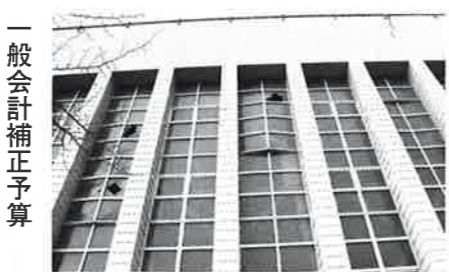
総合体育館の被害
