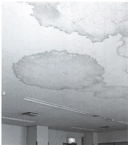
漏水による1階教室の天井
