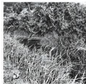
護岸の要望箇所(手前側)
