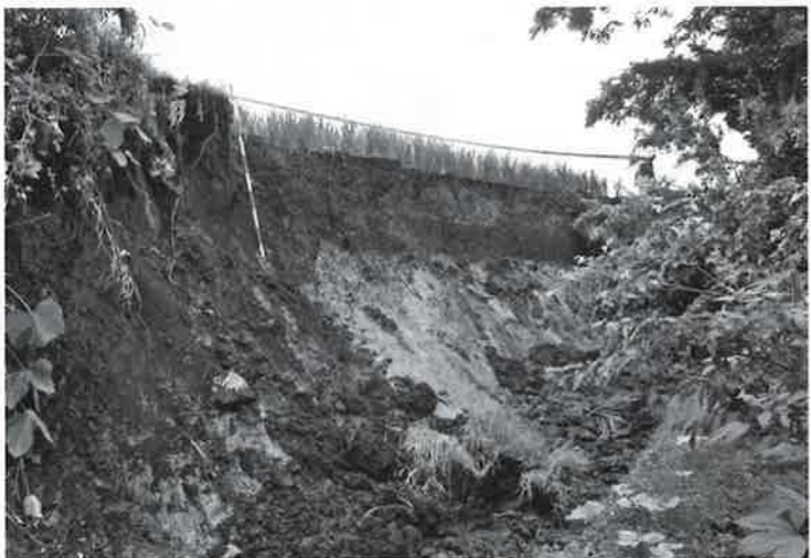
落合で法面崩落
