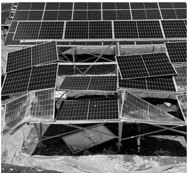
大雪で破損した太陽光パネル
