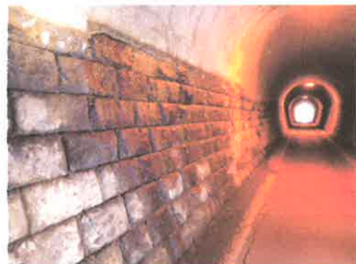
図 3-2 側壁部の漏水(Ⅱ)
