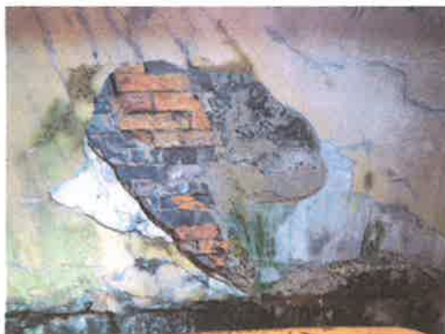
図 3-1 モルタル補修材の剥落(Ⅲ)
