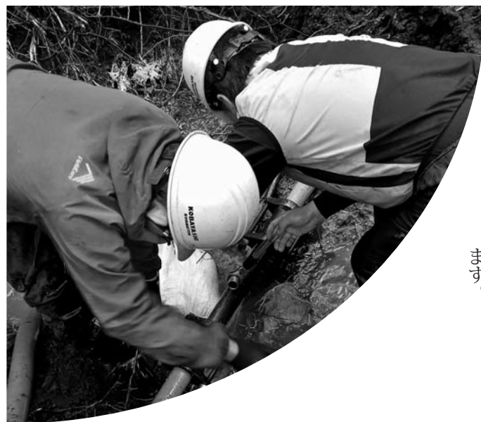
本管事故！修繕中
