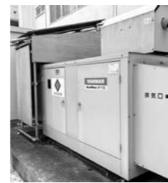
町役場の非常用発電機
